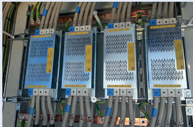
Fig. 5 - Esempio di protezione di un quadro CED già esistente di grandi dimensioni con scaricatori ILF 4P 400
