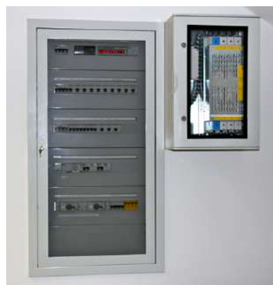
Esempio di protezione di un Data Center con uno scaricatore ILF 4P 250 effettuata in occasione di un ammodernamento
