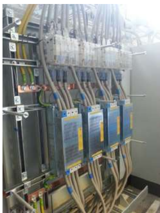
Protection du centre de données réalisée à l'aide de 4 SPD ILF 4P 400 connectés en parallèle.
