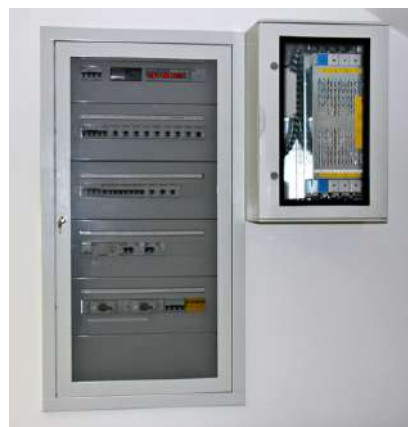
Protection du centre de données réalisée à l'aide d'un ILF 4P 250, installé dans le cadre de la rénovation.
