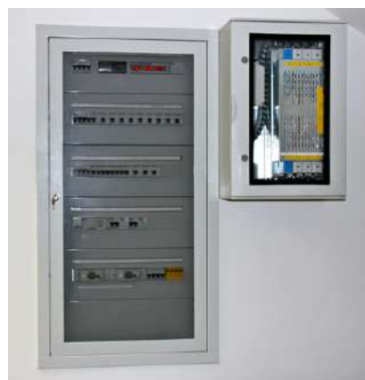
Schutz für ein Datenzentrum, der mit einem ILF 4P 250 im Zuge von Renovierungsarbeiten realisiert wurde
